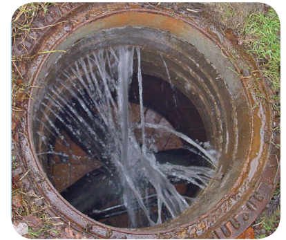
Grundwassereintritt im undichten Kanalschacht.
